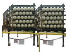
Slika 2 DEPONUJA PUNIH BOCA CNG-a
