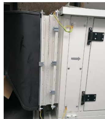
Slika 13. Nepravilni spoj klima-komore i kanalske mreže
